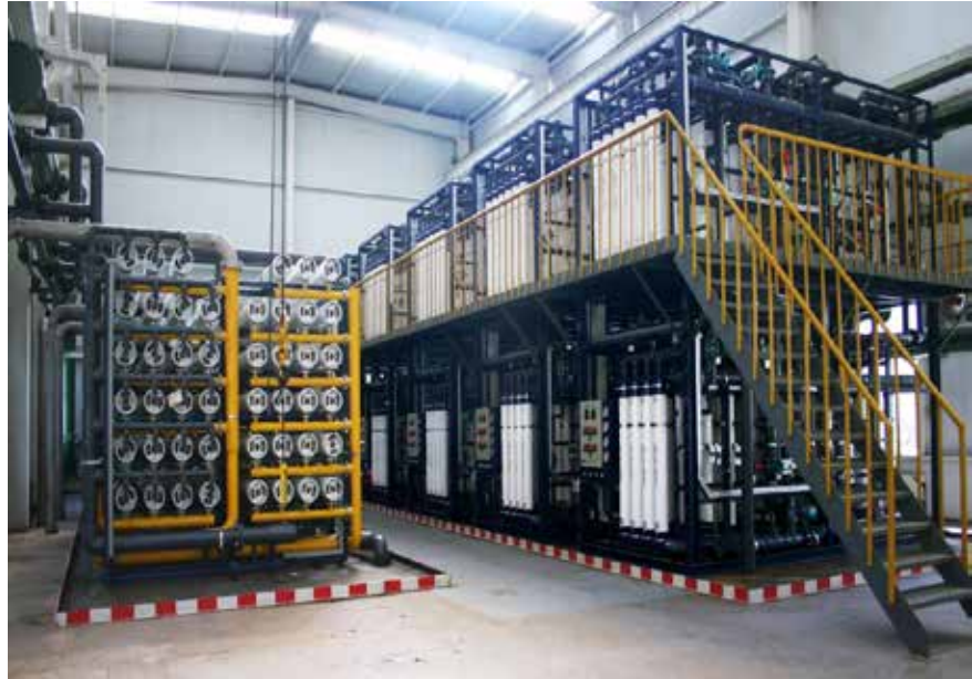
图 1. 燕山石化现场超滤和反渗透系统
