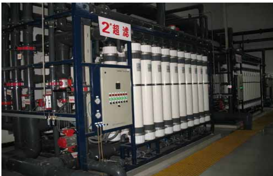
观音山热电厂采用DOW™ 超滤 SFP-2860 膜组件 (照片由南通观音山镇环保热电有限公司提供)
